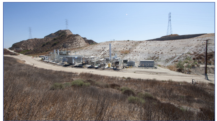
Instalación de conversión de gas en energía en el relleno sanitario de Chiquita Canyon
